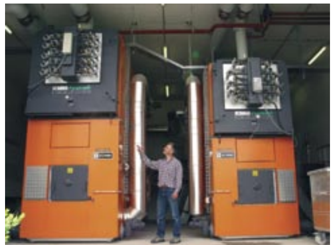
Herzstück der neuen Heizzentrale sind diese beiden leistungsfähigen Holzessel.
