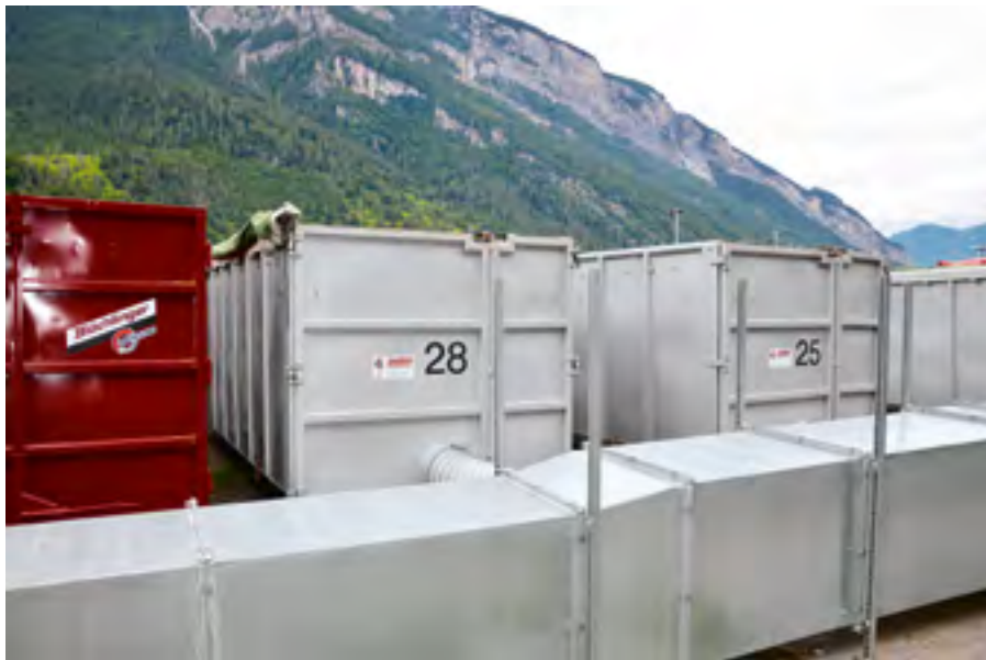
Bei der Container-Trocknung wird das Trocknungsgut von unten mit heisser Luft durchströmt. Bild: R. Hunger
