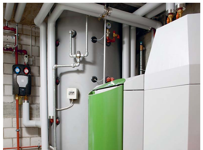
Pelletkessel im Einfamilienhaus Reist
