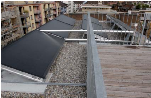
Sonnenkollektoren auf dem Dach der Wogeno, Zürich
