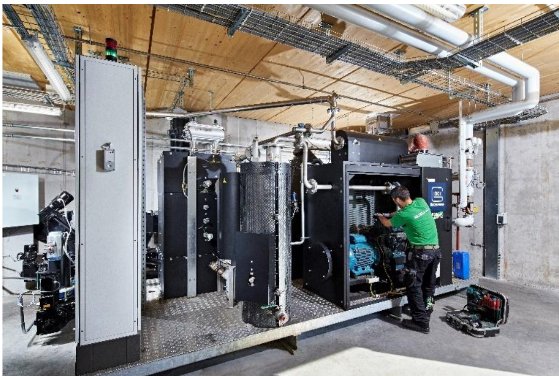
Heim AG - Heizsysteme
