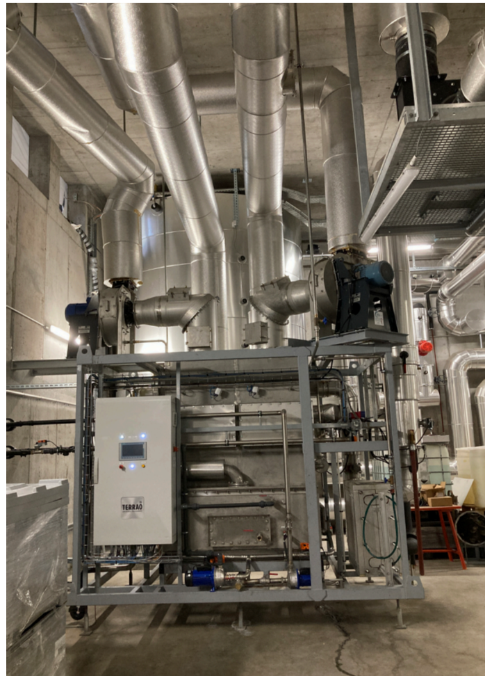
Une des trois centrales de chauffage du réseau de chauffage urbain de Verbier. L'utilisation du système Terraosave pour la condensation et l'épuration des gaz d'échappement ainsi que l'utilisation de pompes à chaleur permettent de récupérer douze pour cent de la chaleur dégagée par les pellets. Photo : Altis
