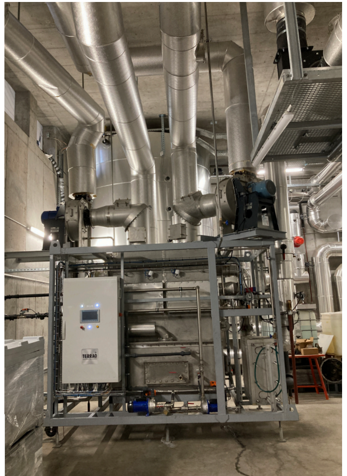
Eine von drei Heizzentralen des Fernwärmenetzes von Verbier. Durch Einsatz des Systems Terraosave zur Abgaskondensation und -reinigung sowie mit Einsatz von Wärmepumpen können zwölf Prozent der Abwärme von Pellets rekuperiert werden. Foto: Altis
